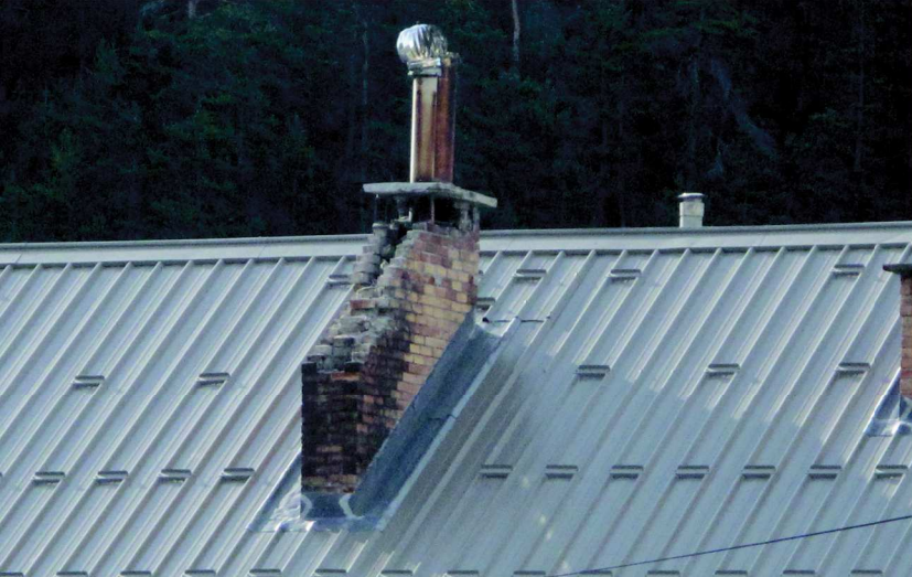
Cheminée endommagée Vallée de l'Ubaye
